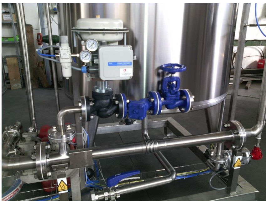
Scambiatore di calore automatico per riscaldamento
